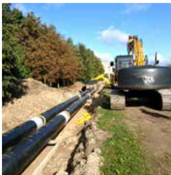
Pernai Kurtuvėnų–Kelmės–Pramonės–Liejyklos gatvių kvartale pradėti šilumos perdavimo tinklų rekonstravimo darbai bus tęsiami šiemet ir užbaigti kitų metų pradžioje.
