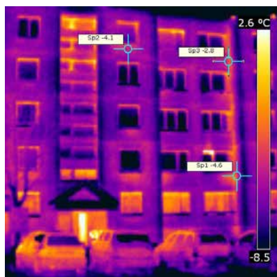
Termogramoje išryškėja pastato vietas, pro kurias „išeina“ šiluma.
